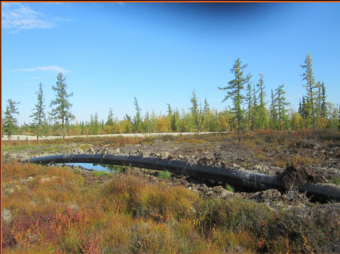
Аварийный участок нефтепровода на ПК 328+00
